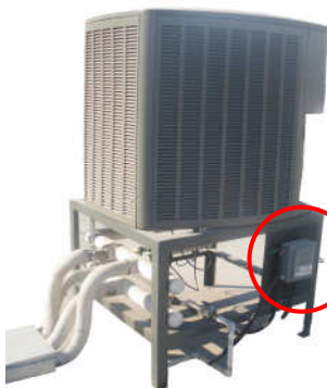
Interruptor de servicio
