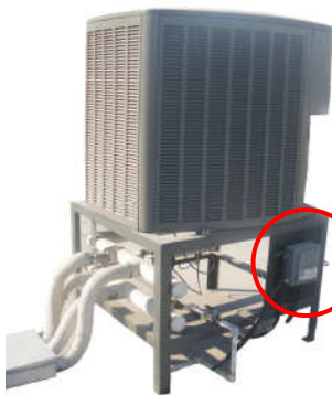
Interruptor de servicio
