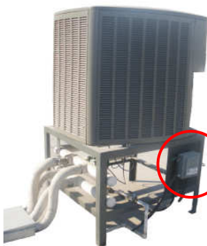
Interruptor de servicio
