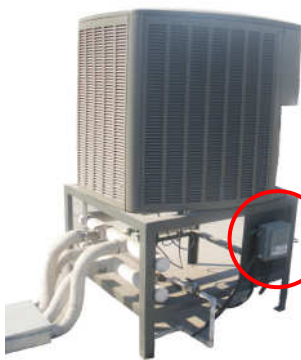
Interruptor de servicio
